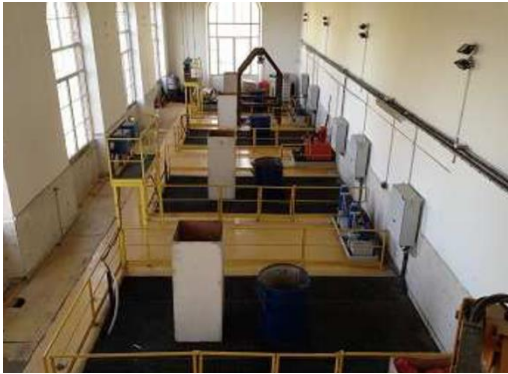
Figure 11 : Photos de l'installation hydroélectrique de Rieux de Pelleport
